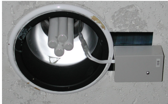
(b) 電源供給ユニットの設置例
